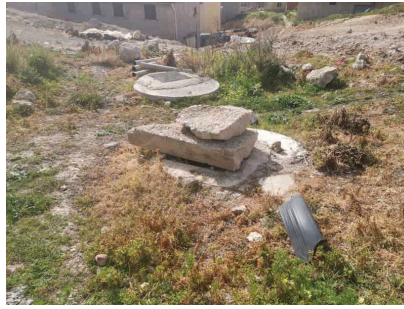
Fig. 2 – Tombini coperti da massi al posto di coperture ermetiche
