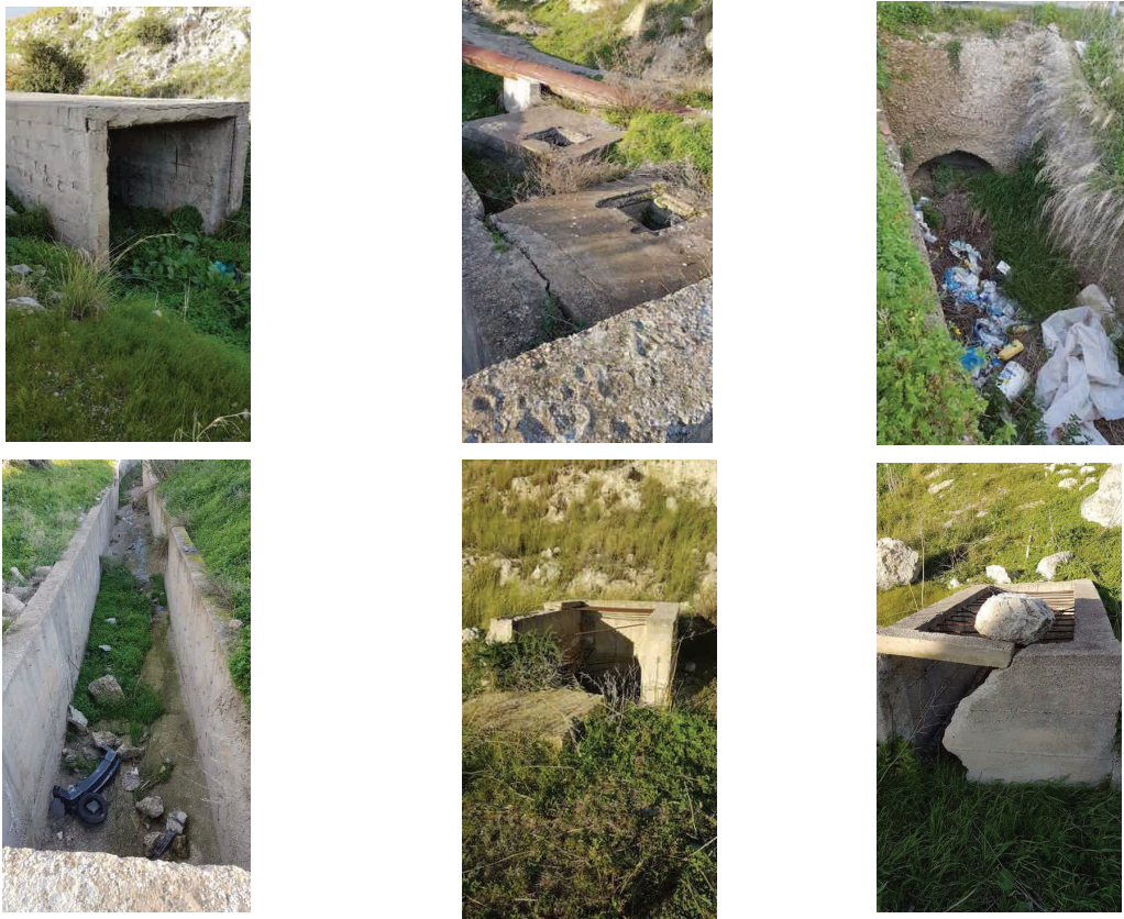
Fig. 4 – Foto del secondo canalone
